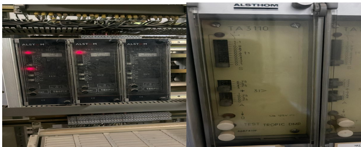
Relais de protection mécaniques
