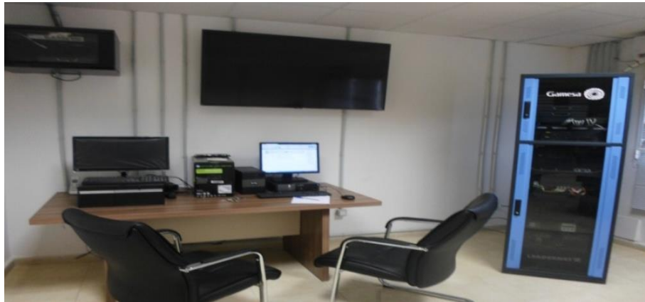
l'intérieur de la salle SCADA
